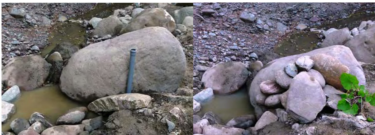
Figura 11 Exemplu de piezometru cu diver pentru monitorizarea nivelului apei instalat în deplasarea de la Zlatna din septembrie 2009. În stânga: după instalare, în dreapta: după mascare.
